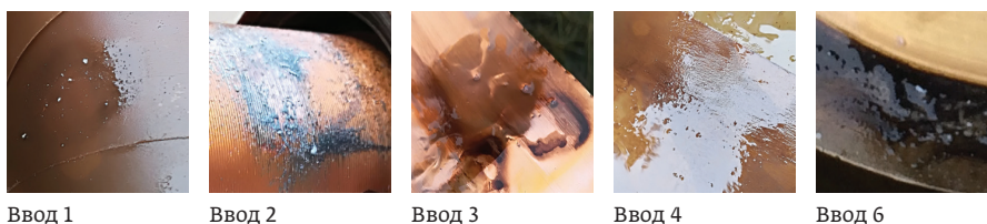
Рис. 1. Внешний вид воскообразных отложений на различных частях высоковольтных вводов с бумажно-масляной изоляцией
